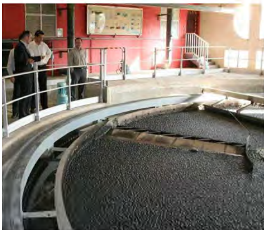
La station d'épuration de Saint-Palais-sur-Mer, associée à celle des Mathes, rejettent toutes les deux 4,5 millions de mètres cubes d'eau usée traitée par an. R.C.
