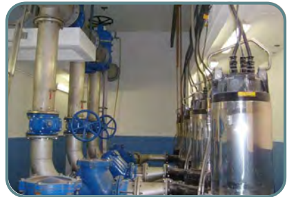
Postes de refoulement du « Rhâ » à Saint-Palais-sur-Mer.
